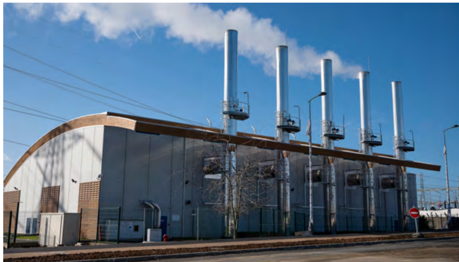
La chaufferie des Linandes
